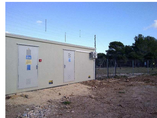
Exemple de poste de livraison – Parc solaire du Castellet – VOLTALIA
