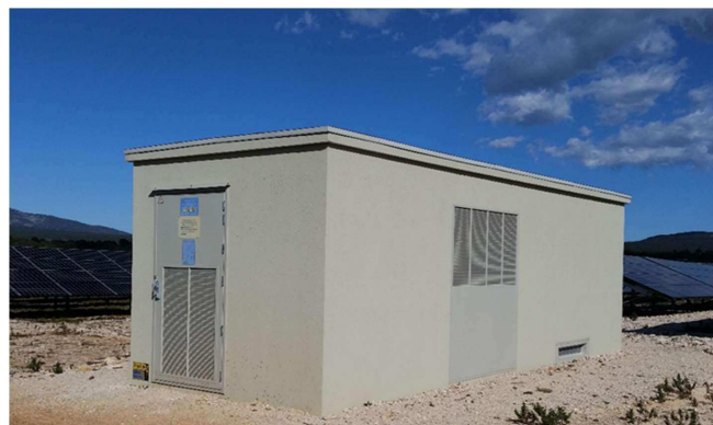
Exemple de poste de transformation – Parc solaire du Castelet- VOLTALIA
