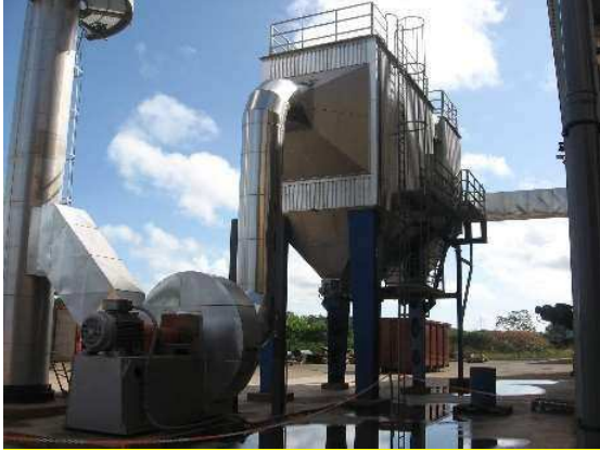
Centrale biomasse – Source : VOLTALIA
